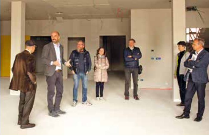
Le visite al cantiere sono state guidate dall'architetto Remo Capitanio, progettista e direttore dei lavori in corso.
